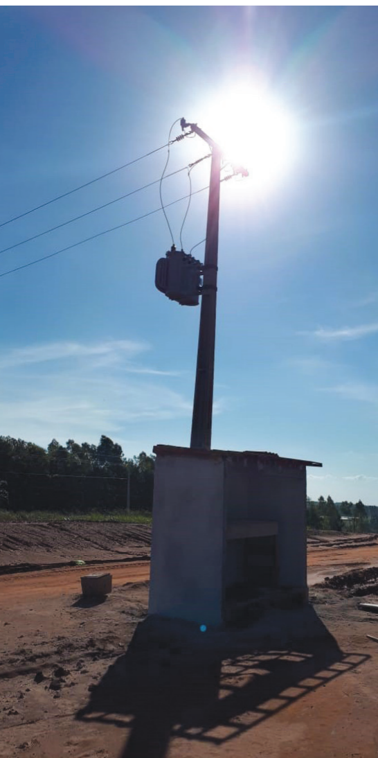
Subestação e medição de energia
