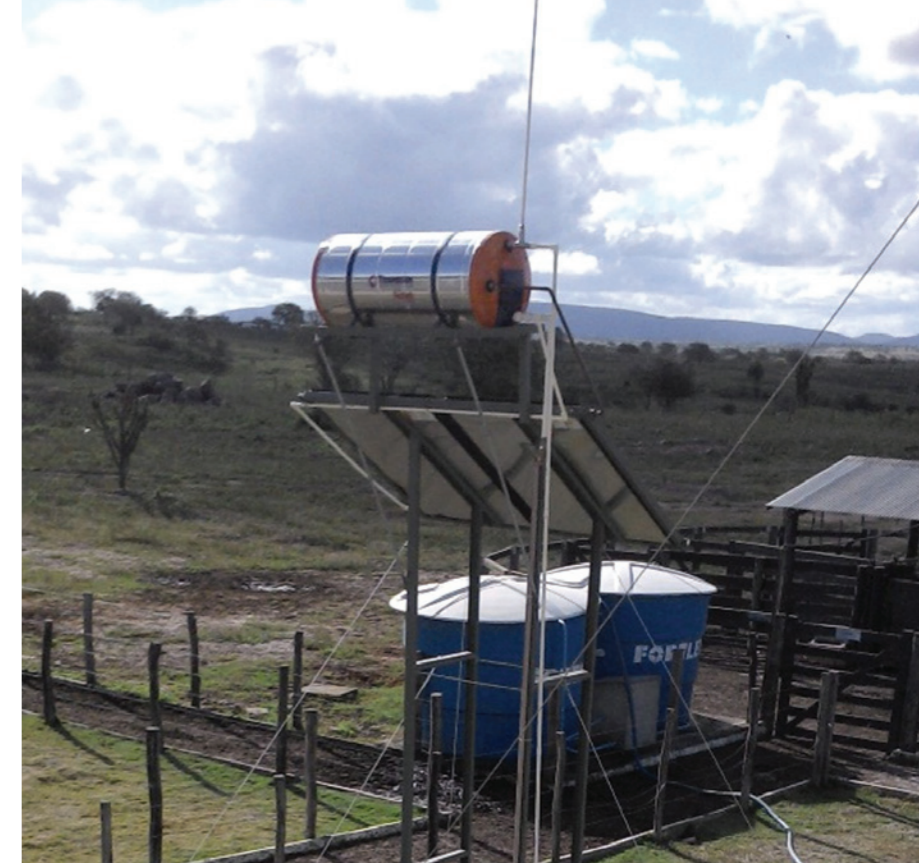
Aquecimento de água com placas solares.
