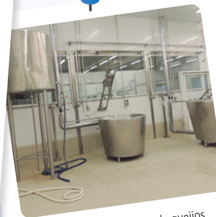
Sala de processamento de queijos da El Piamontés
